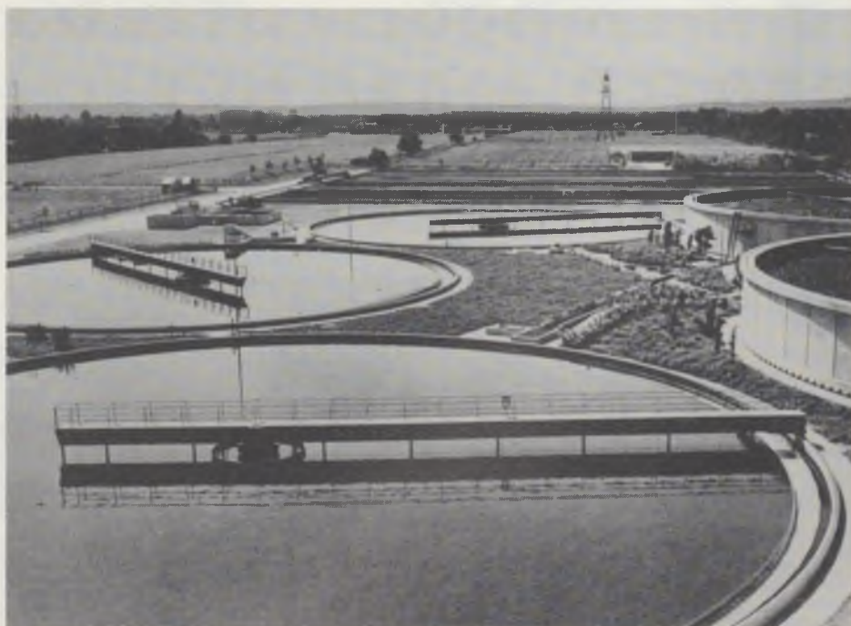
Een zuiveringsinstallatie in Veenendaal.
