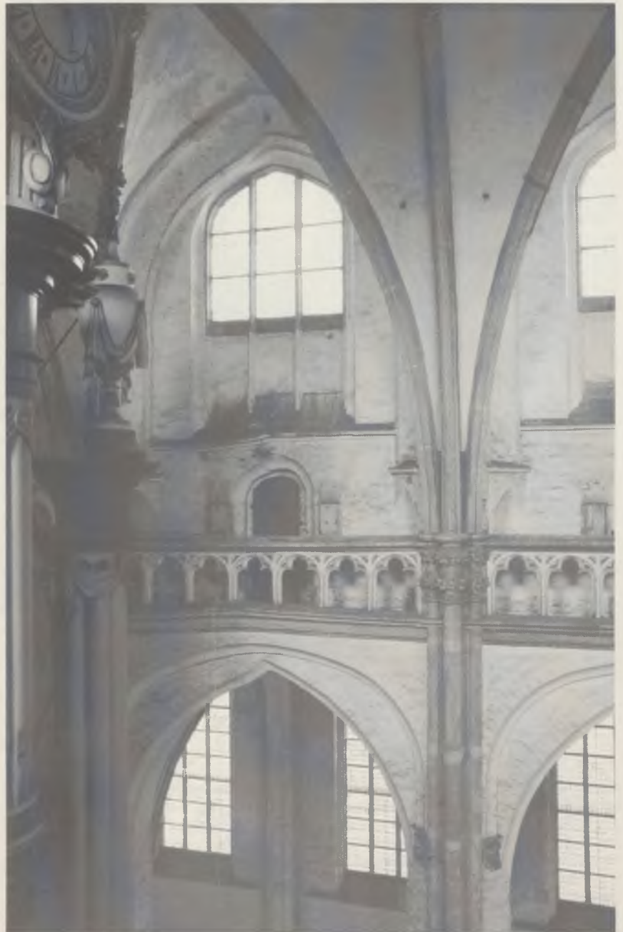
Afb. 8 De westelijke travee van de noordwand van de St. Maartenskerk. Duidelijk zichtbaar is de zettingsschade.
